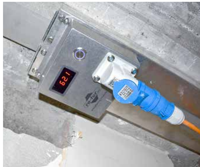
6 Temperatuurcontrole tijdens het verwarmen via de ingebouwde regelenheid. conform Protocol de gegevens vastleggen
