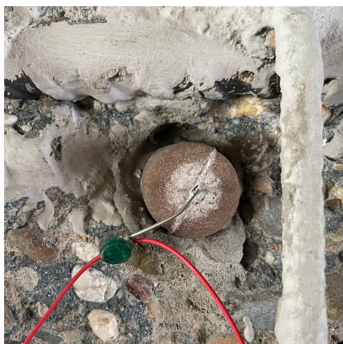
Close-up aansluiten geplaatste opofferanode
